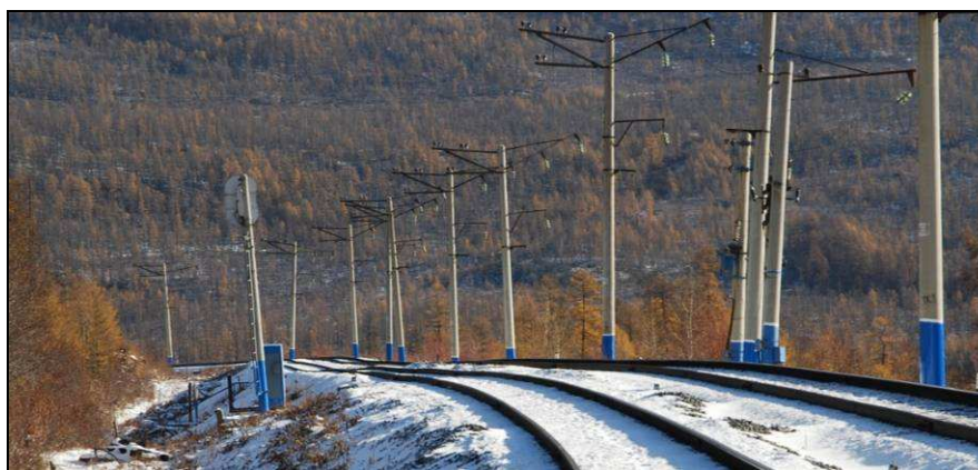
Рис. 1. Деформации пути на 1832 км Восточно-Сибирской ж.д., 8.10.2010 г.
